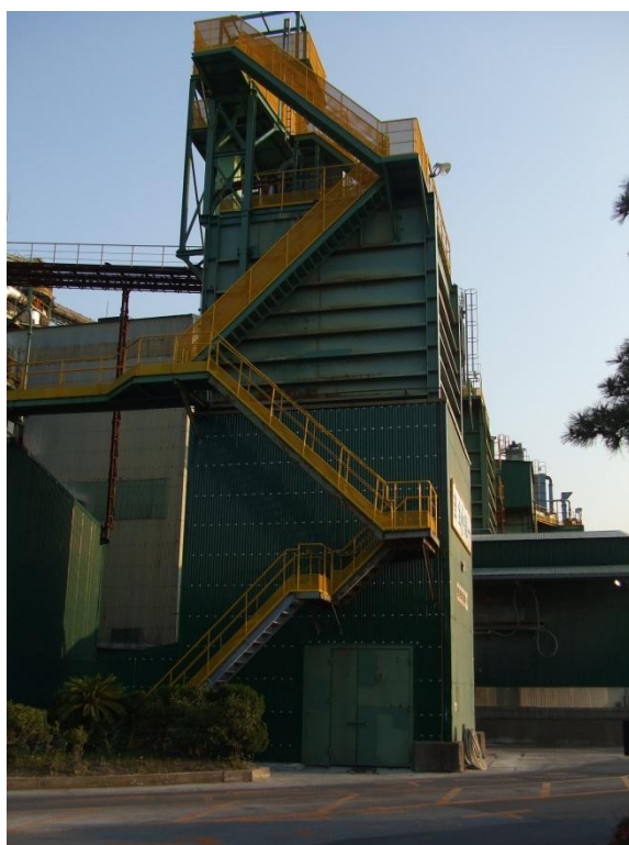
中性固化材製造設備外観
