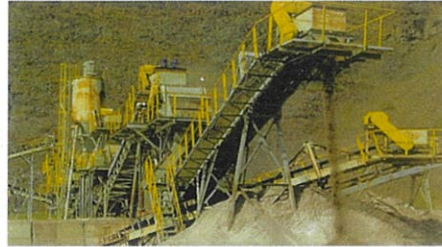
【混合プラント】
