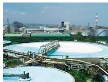
③反応・濃縮設備 海水中のマグネシウムを 抽出・凝集させる設備
