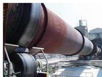
④焼成設備 (ロータリーキルン) 水酸化マグネシウムを 1800℃以上で焼成しマグ ネシアクリンカーを生産 する設備
