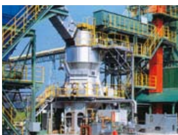
②粉碎工程(粉碎設備) 石灰石を粉碎し炭酸カル シウムを生産する設備
